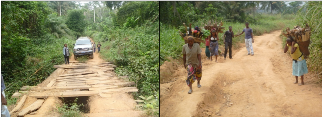
Figure 15. À gauche, Pont en mauvais état et à droite route de desserte agricole mal entretenue.
